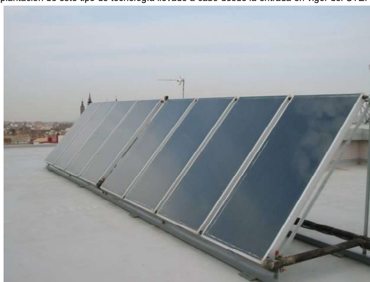
Instalación solar térmica edificio Trovador (Zaragoza)
