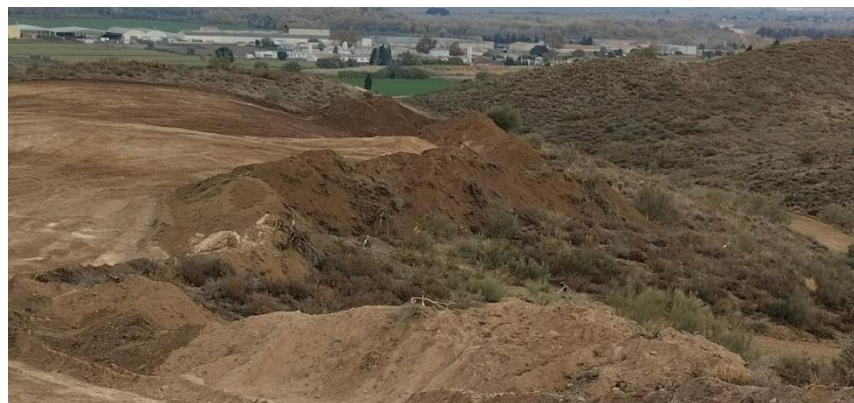
Caballones de tierra vegetal en los márgenes de la plataforma del ACS 01: se aprecia el jalonado que delimita la zona de ocupación prevista, que no se ha superado (09-12-22).
