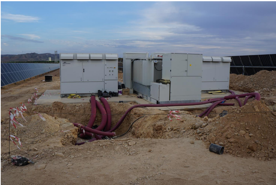
Figura 5 Conexión de estación de transformación eléctrica
