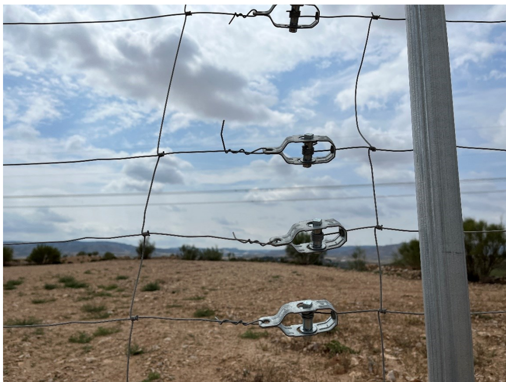
Figura 10 Elementos punzantes en el vallado perimetral
