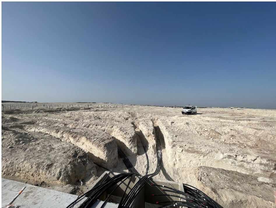
Figura 11 Cableado de la red
