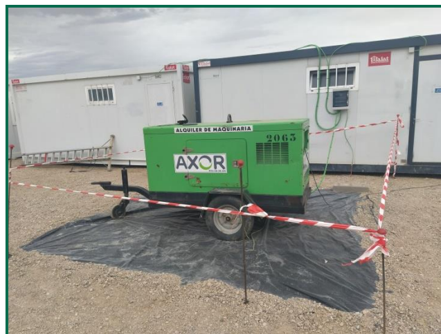
Fotografía 9. Grupo electrógeno, y baños.
