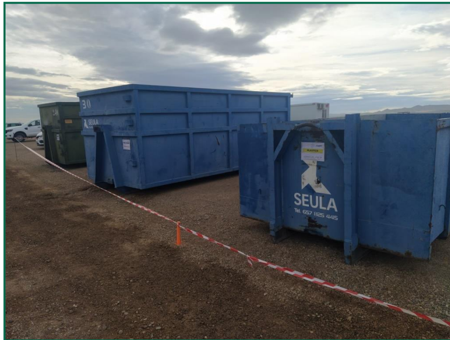
Fotografía 6. Contenedores para voluminosos.
