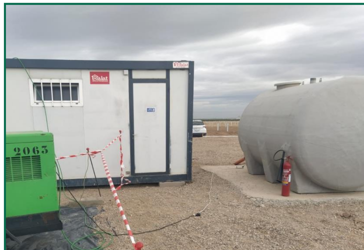
Fotografía 11. Extintor junto a grupo electrógeno.
