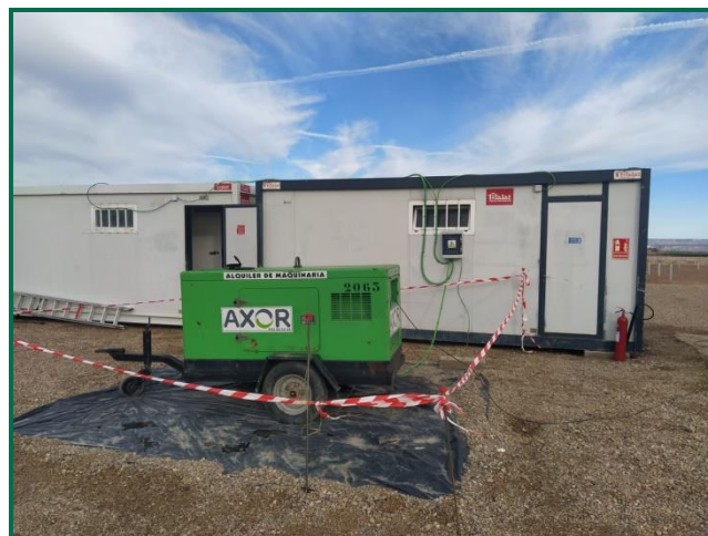
Fotografía 7. Grupo electrógeno, y baños.
