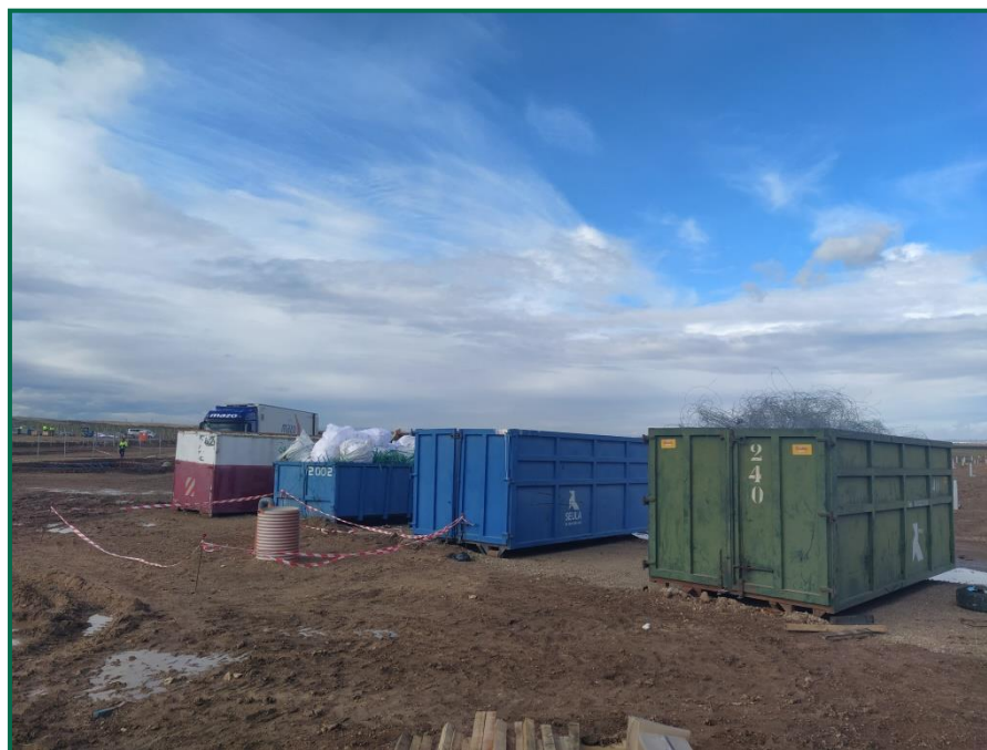
Fotografía 8. Contenedores para voluminosos.
