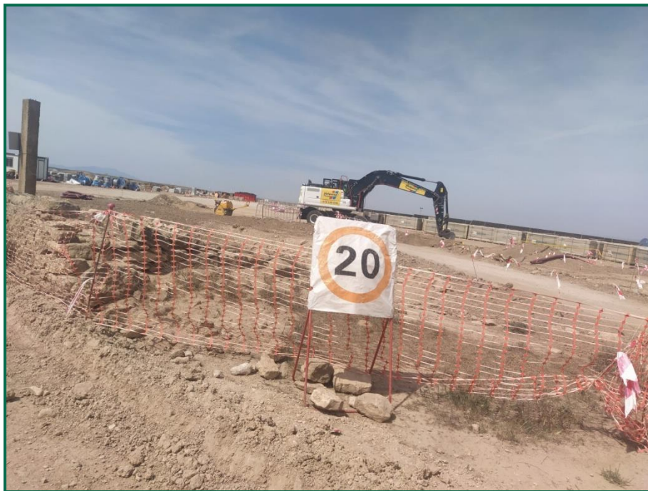
Fotografía 4. Señal de limitación de velocidad.
