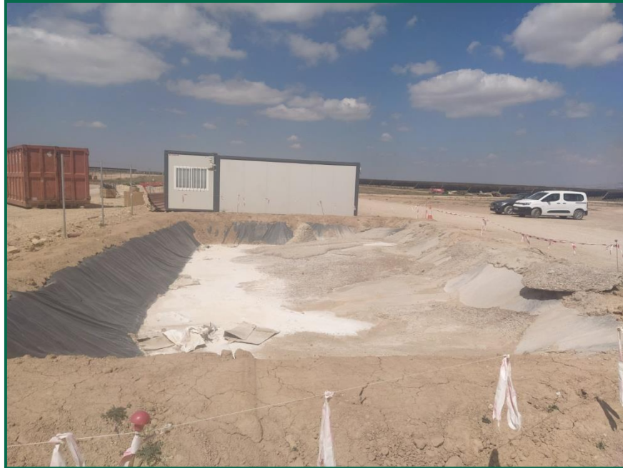
Fotografía 7. Zona de lavado de hormigón.
