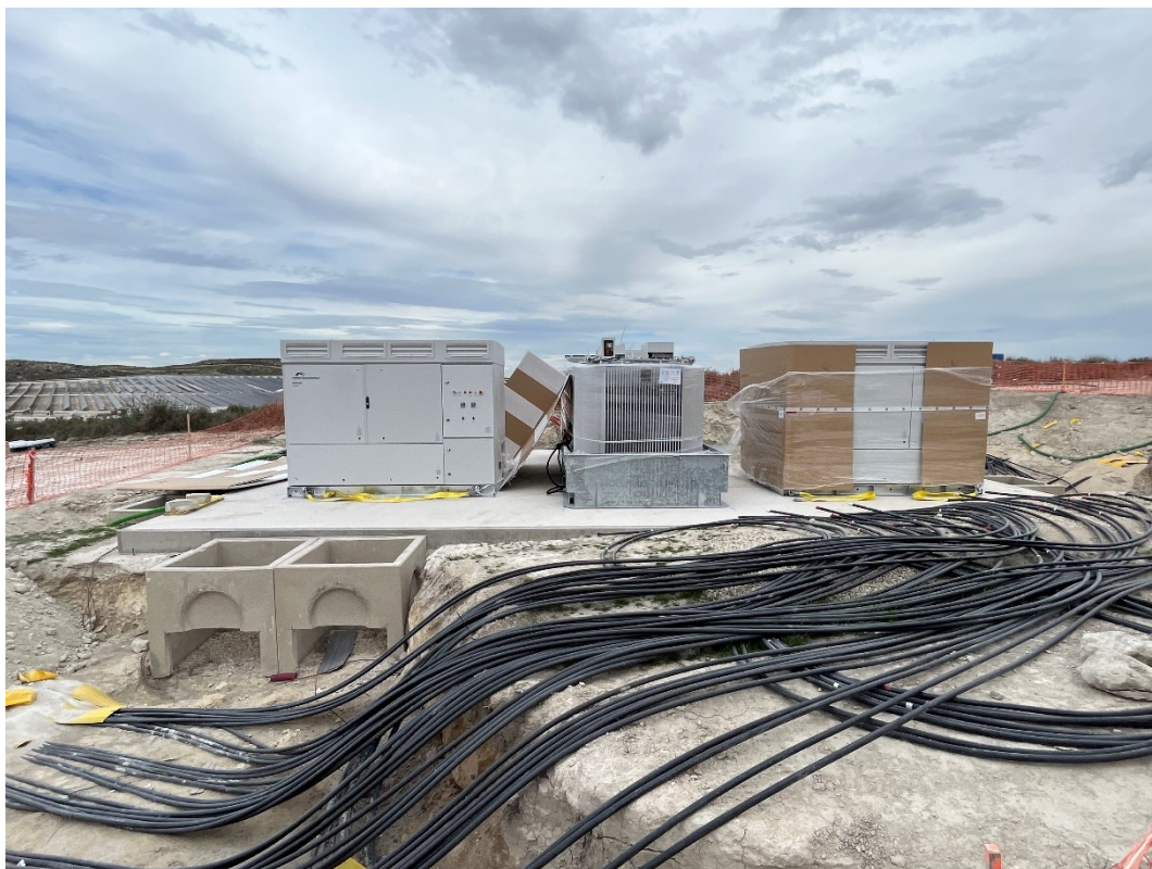
Figura 11 Montaje de los centros de transformación
