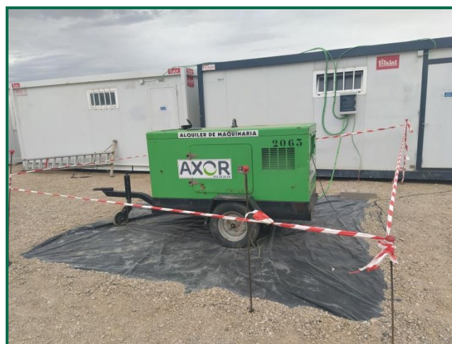
Fotografía 9. Grupo electrógeno, y baños.
