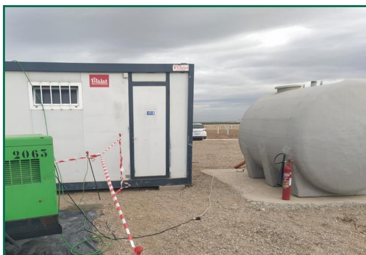
Fotografía 11. Extintor junto a grupo electrógeno.
