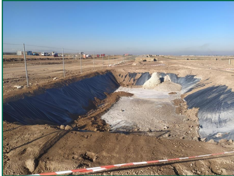
Fotografía 5. Zona de lavado de hormigón.
