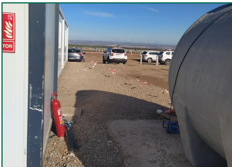
Fotografía 9. Extintor junto a grupo electrógeno.
