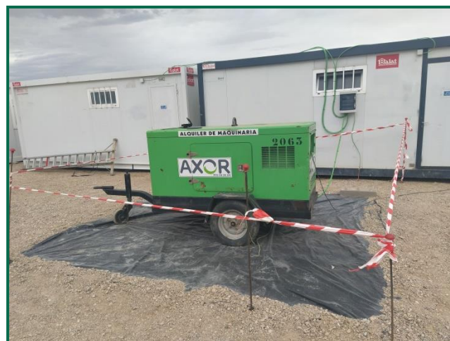
Fotografía 9. Grupo electrógeno, y baños.
