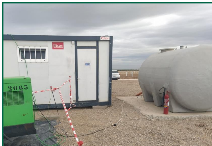
Fotografía 11. Extintor junto a grupo electrógeno.
