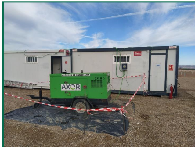
Fotografía 7. Grupo electrógeno, y baños.
