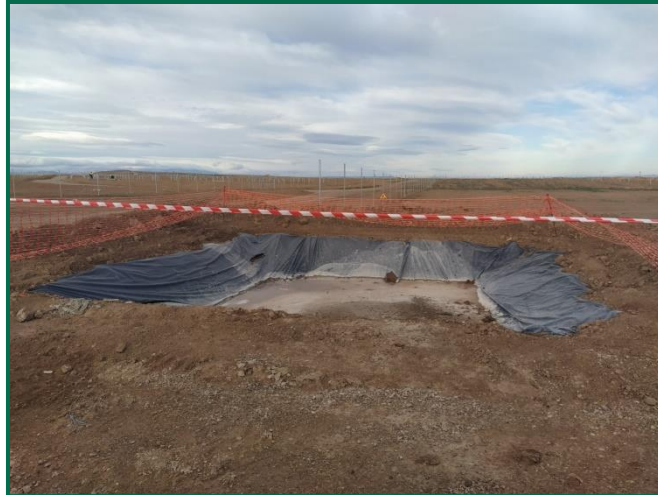
Fotografía 6. Zona de lavado de hormigón.
