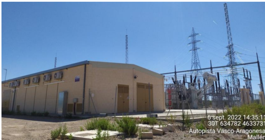
Figura 39: Subestación eléctrica Valcardera, SET asociada a PE “Multitecnología” en la que se realiza la gestión de residuos del PE, así como la ubicación del arcón refrigerador para la conservación de siniestros asociados al PE.
