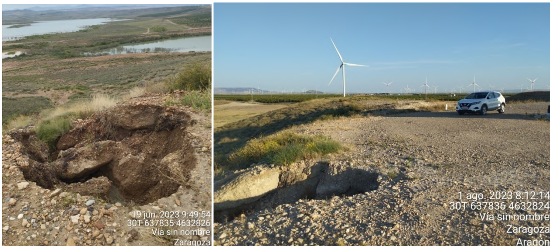
Figura 23: Fotografía de la erosión acusada del talud al sur de la plataforma del aerogenerador MU-09. EL proceso erosivo había sido informado en anteriores informes cuatrimestrales y fichas de visita, pero las lluvias torrenciales ocurridas a lo largo del verano de 2023 han agravado el proceso erosivo.
