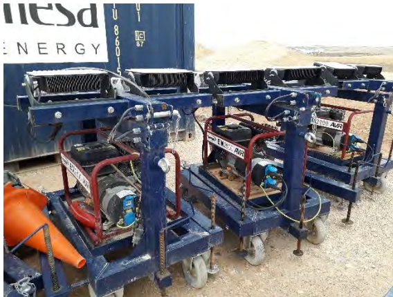
Grupos eléctricos con cubeto antivertidos.
