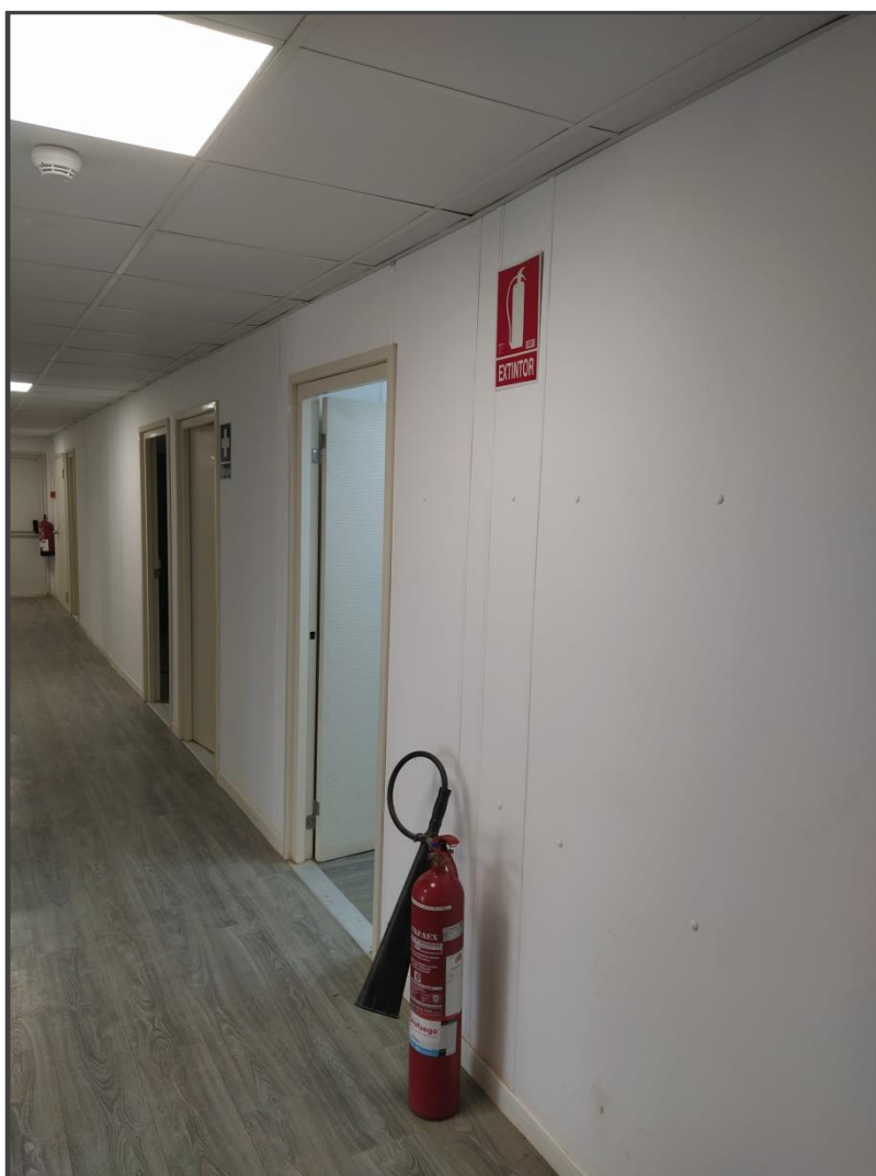
Fotografía 11. Extintores en edificio de control.
