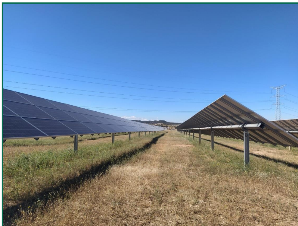
Fotografía 2. Vegetación entre placas actualmente.
