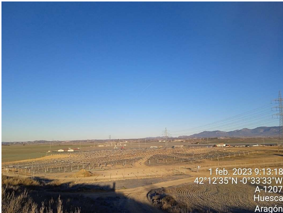
Imagen 4.- Vista general de la planta solar desde el acceso este.
