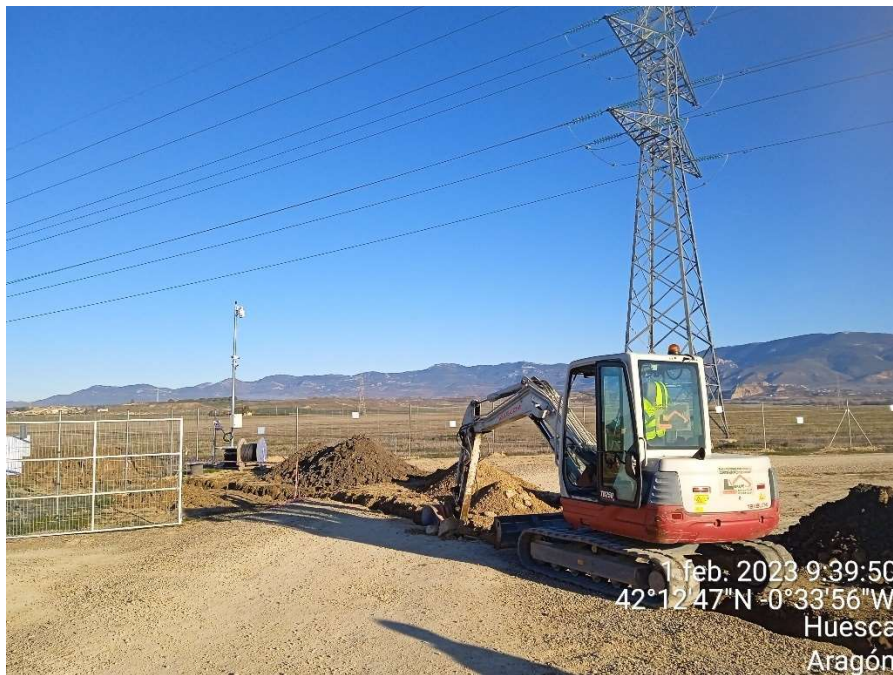
Imagen 1.- Apertura de la zanja de la línea de evacuación de la planta fotovoltaica, cerca de la puerta de entrada a las instalaciones.
