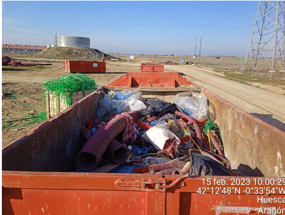
Imagen 13.- Contenedor de plásticos en el Punto limpio de Residuos no peligrosos.
