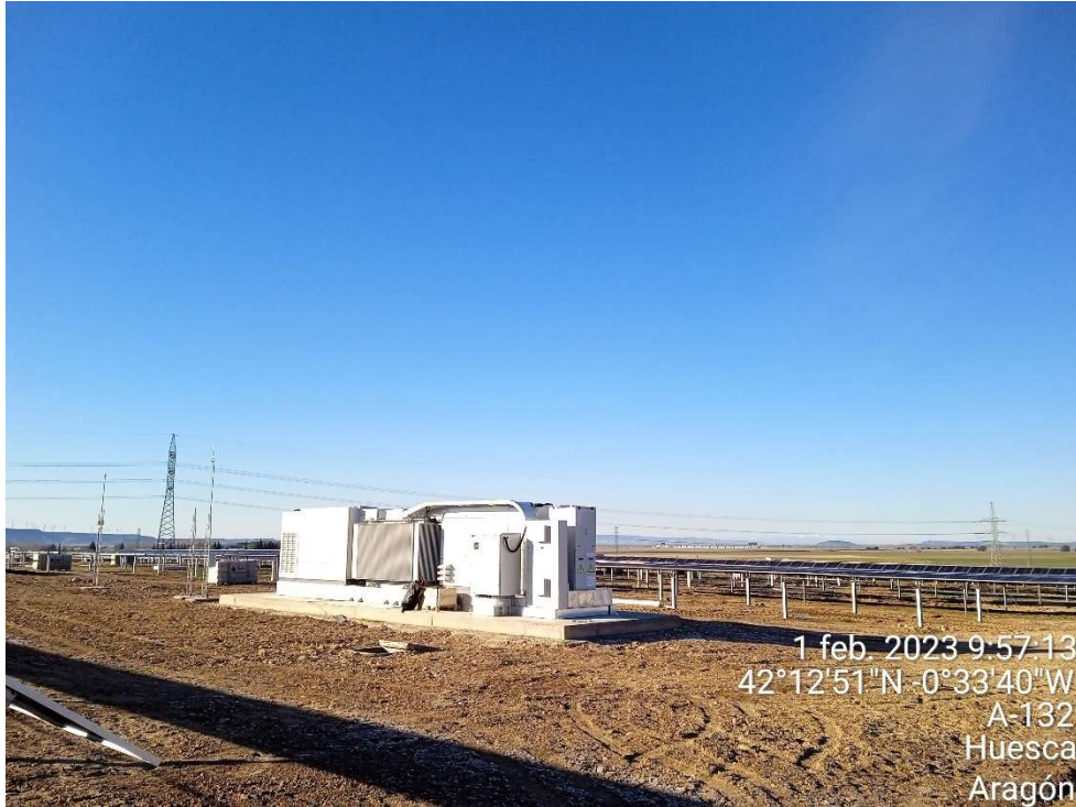
Imagen 9. Uno de los tres Centros de Transformación.
