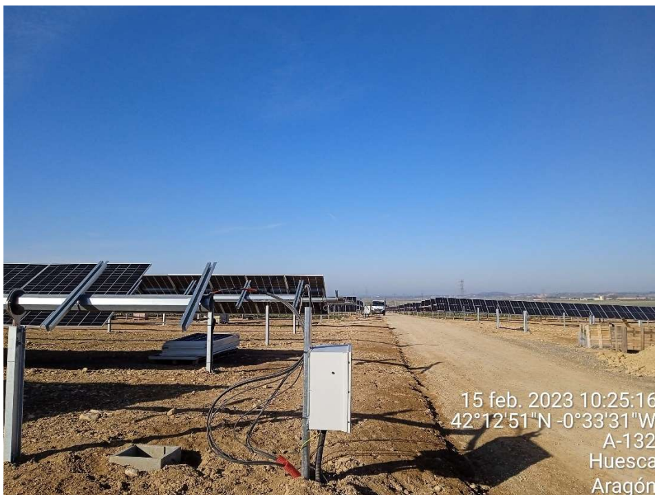
Imagen 6. Seguidores de los módulos fotovoltaicos, conexión con las conducciones de baja tensión y módulos preparados para su instalación.
