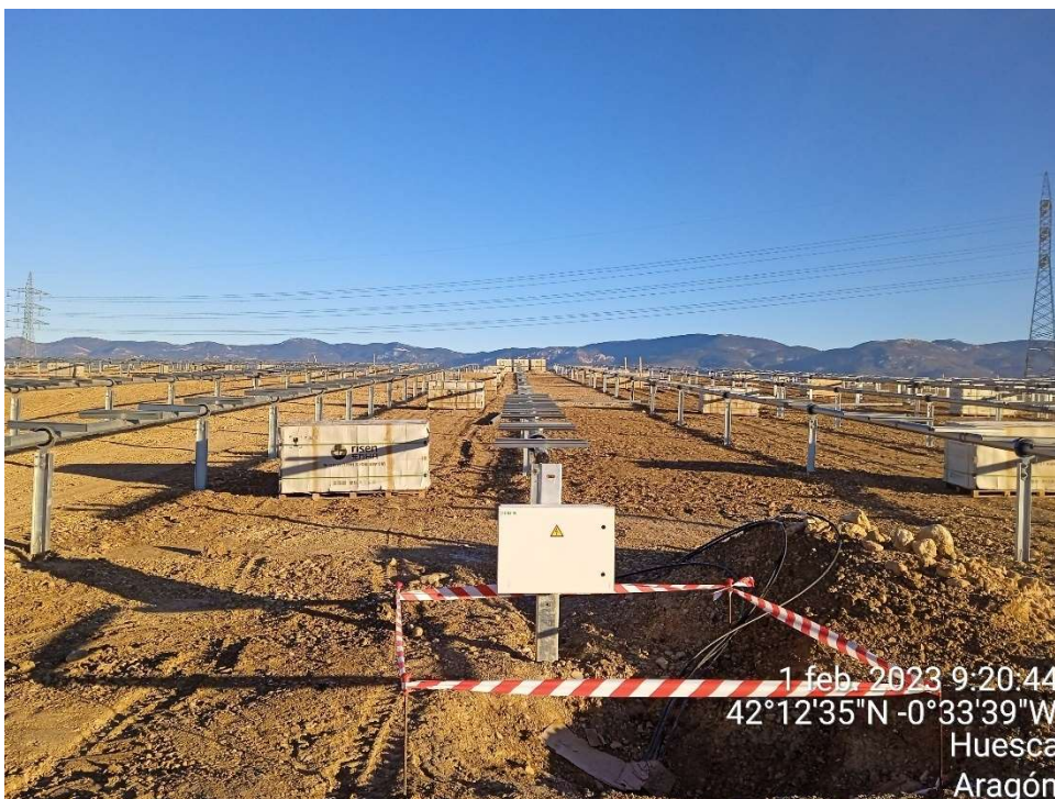
Imagen 6. Seguidores de los módulos fotovoltaicos, conexión con las conducciones de baja tensión y módulos preparados para su instalación.
