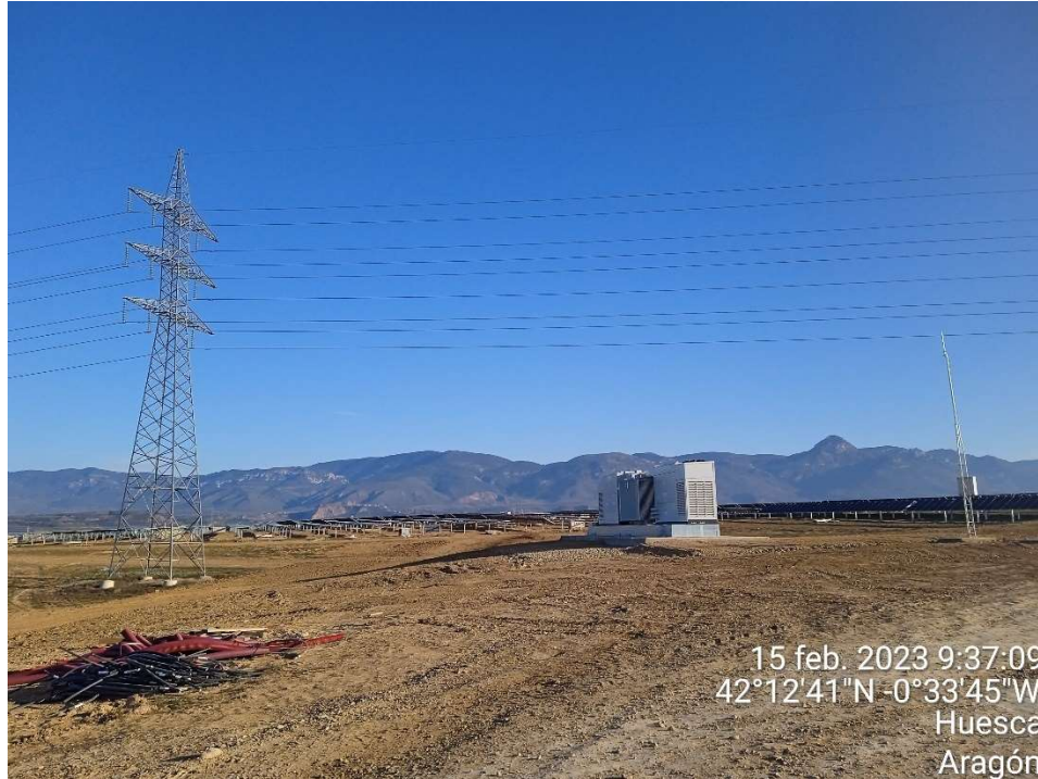
Imagen 9. Uno de los tres Centros de Transformación.
