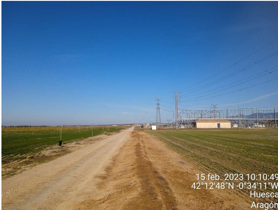
Imagen 3.- Situación final del camino y campo de cultivo después los trabajos en la línea de evacuación.
