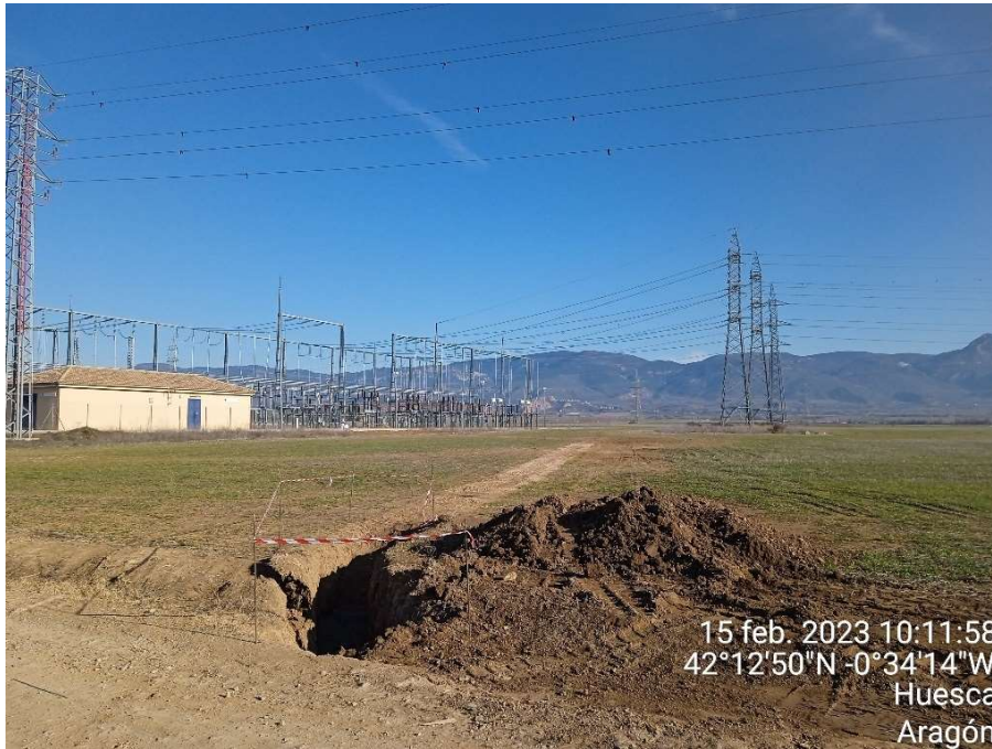
Imagen 1.- Entrada de la línea de evacuación de la planta fotovoltaica en la SET 132kV Esquedas.
