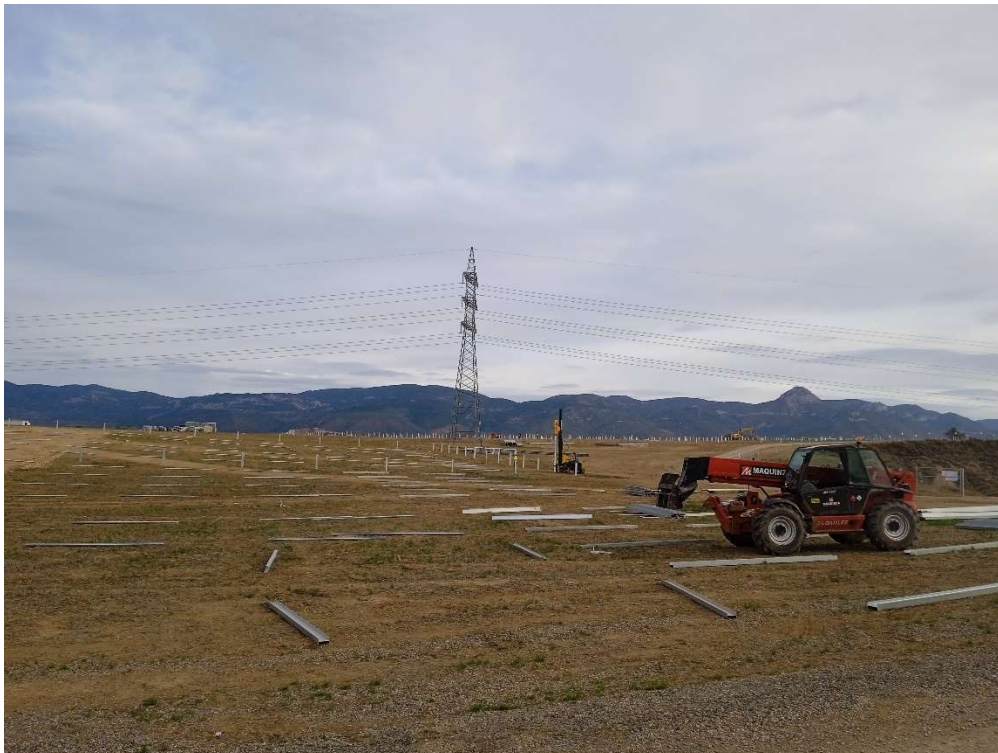
Imagen 4. Manitou depositando los postes de los seguidores en el terreno e hincadora trabajando.
