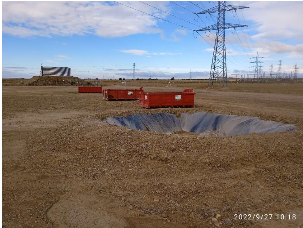
Imagen 17.- Punto limpio de Residuos no peligrosos habilitado durante la fase de construcción, con la balsa de limpieza de hormigoneras en primer plano.
