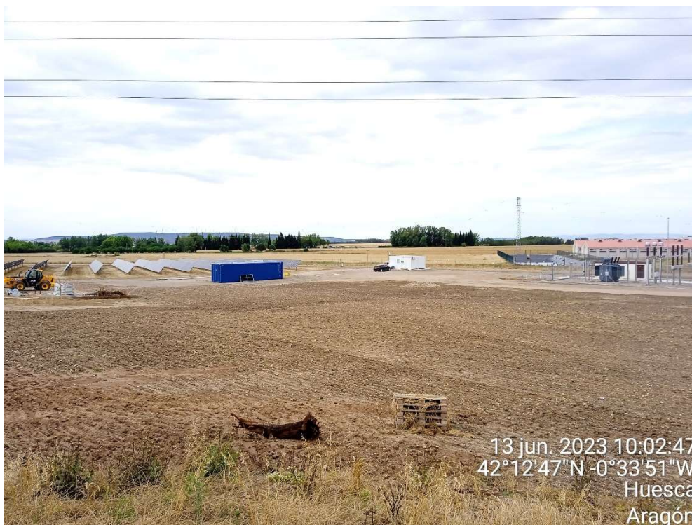
Imagen 23.- Zona de instalaciones desmantelada, tras las labores de descompactado del terreno para la regeneración de la vegetación. El contenedor azul y el material restante se quedarán para labores de mantenimiento en la fase de explotación.
