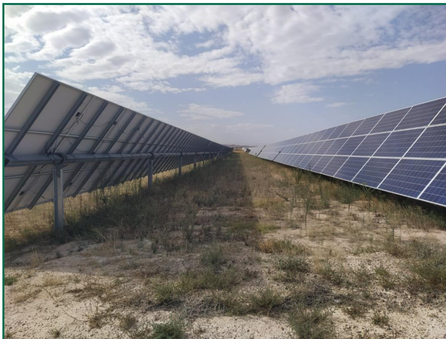
Fotografía 1. Vegetación entre placas en su estado actual.
