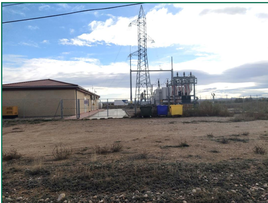
Fotografía 5. Contenedores para residuos en la SET.
