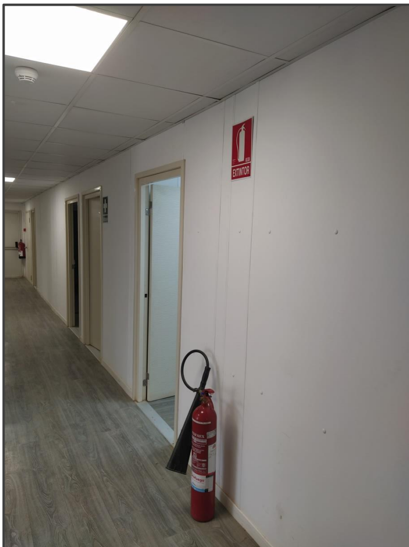
Fotografía 7. Extintores en edificio de control.
