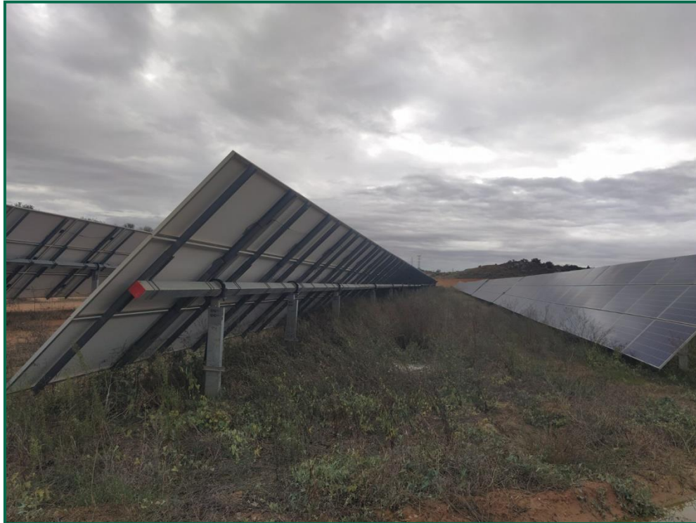
Fotografía 1. Vegetación entre placas actualmente.
