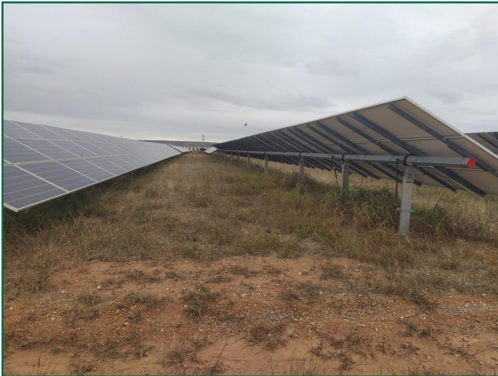
Fotografía 1. Vegetación entre placas actualmente.
