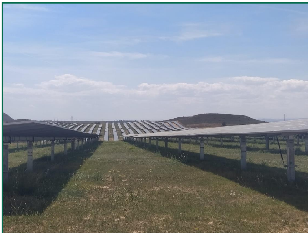
Fotografía 1. Vegetación entre placas actualmente.
