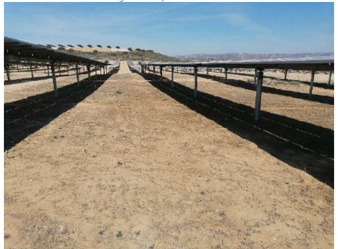
Fotografía 52.- Estado del suelo en bloques de construcción reciente. Cubierto vegetal rala y escasa. Febrero 2022.
