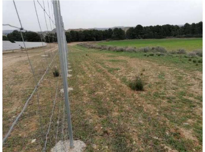
Fotografía 20.- Estado de las plantaciones perimetrales (semi-vallado Este, lado Norte). Marzo 2022.
