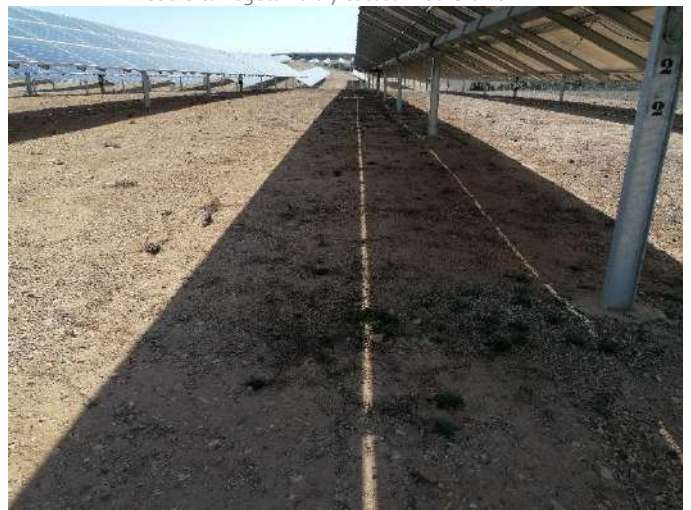
Fotografía 54.- Estado del suelo en bloques de construcción reciente. Cubierto vegetal rala y escasa. Febrero 2022.
