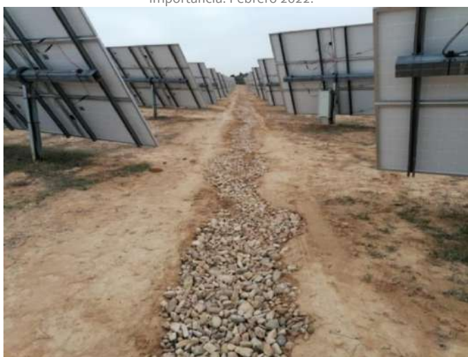
Fotografía 03.- Procesos erosivos. Reparación de cárcavas incipientes que comprometían el tránsito de vehículos. Marzo 2022.
