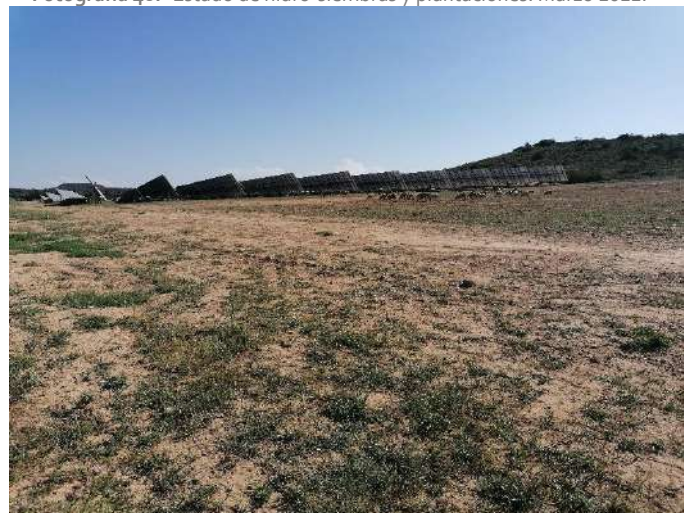
Fotografía 48.- Estado de hidro-siembras. Cubierta vegetal rala y escasa. Abril 2022.
