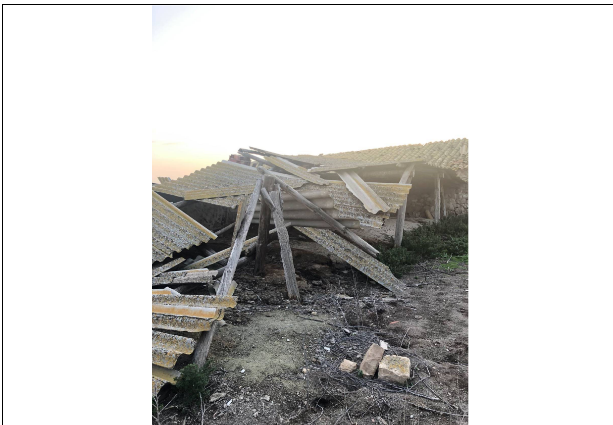
Gráfico 22º.- Foto del cubierto hundido que permite el acceso a los tejados de la paridera
