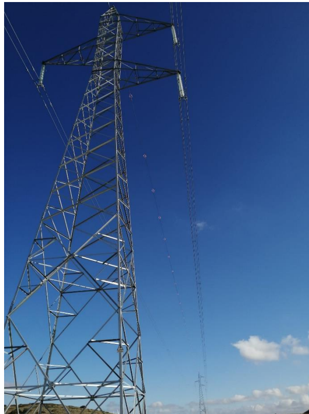
Fig 1. Puntos control en la revisión de balizas salvapájaros en la LAAT LM6 – LM2. Fuente: elaboración propia.
