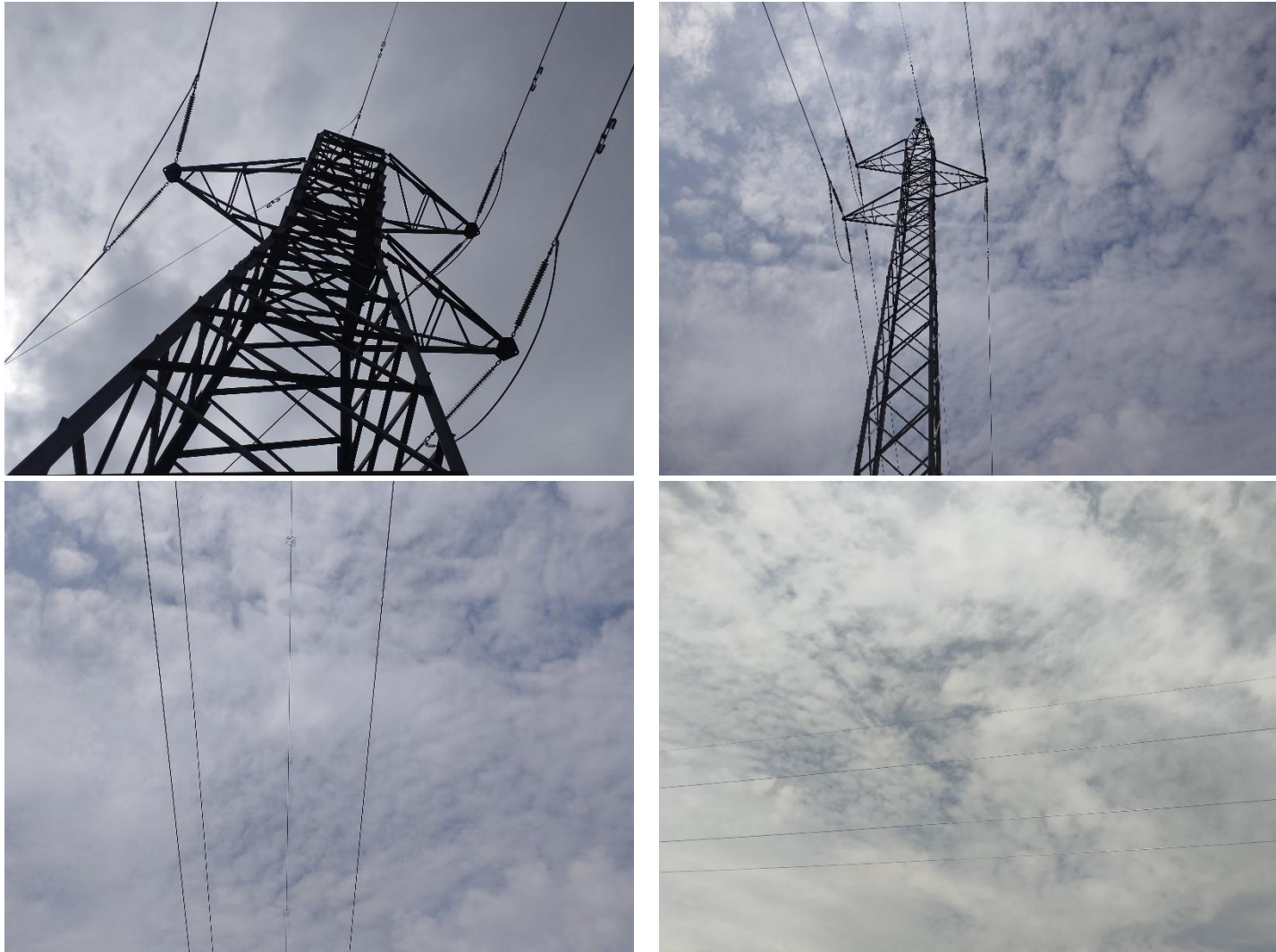
Fotografías 5 a 8: Apoyos de celosía y tendido con salvapájaros
