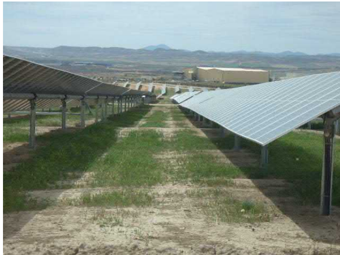
Imagen 7: Vegetación natural en las calles entre paneles solares.
