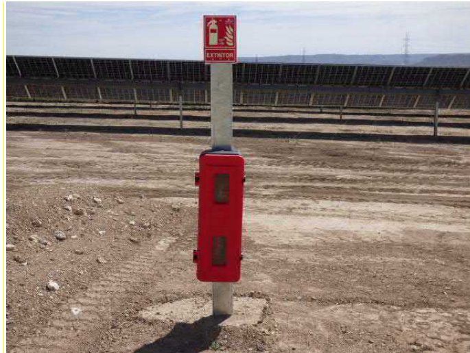
Imagen 16: Fotos de extintor disponible junto al centro de transformación.
