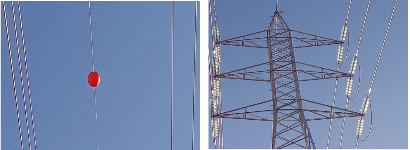
Imágenes 1 y 2: Estado de conservación de baliza esférica (Izquierda), y aisladores (derecha)
