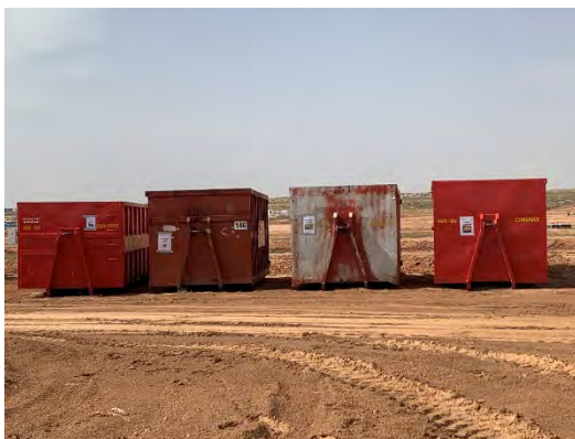
Figura 25 Punto limpio de residuos no peligrosos
