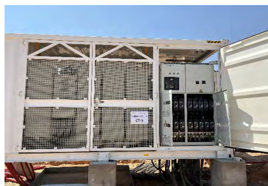
Figura 12 Cableado de los centros de transformación
