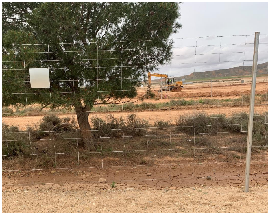
Figura 12 Vallado perimetral de la zona de casetas subsanado
