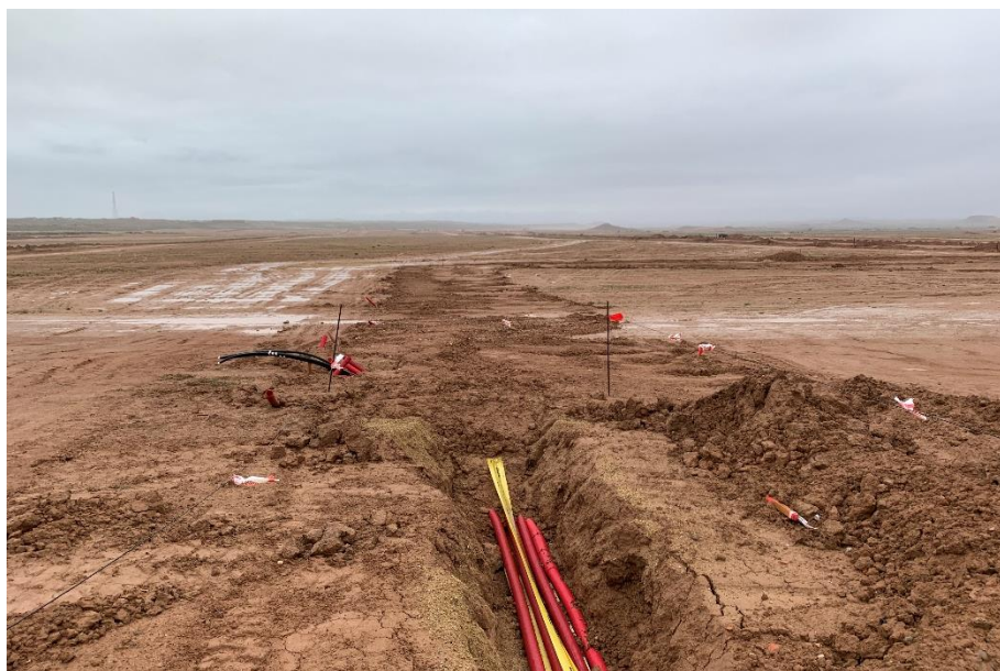
Figura 7 Cableado de la RMT
