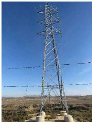
Figura 3: Cruce aéreo río Flumen. Apoyo 1 y Apoyo 2 de la LAAT
