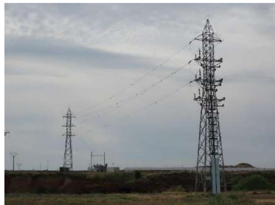
Figura 10. Apoyo 1 y 2 de la LAAT.
