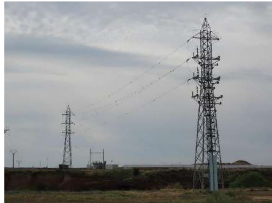
Figura 8. Apoyo 1 y 2 de la LAAT
