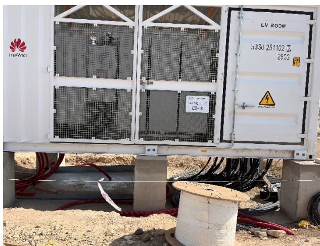
Figura 2 Centro de transformación
