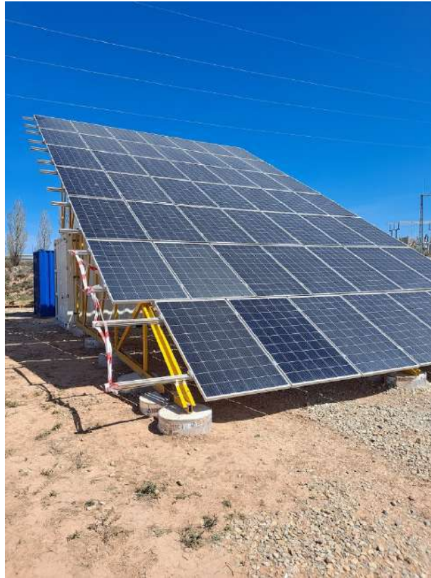
Isla solar autónoma instalada y en funcionamiento
