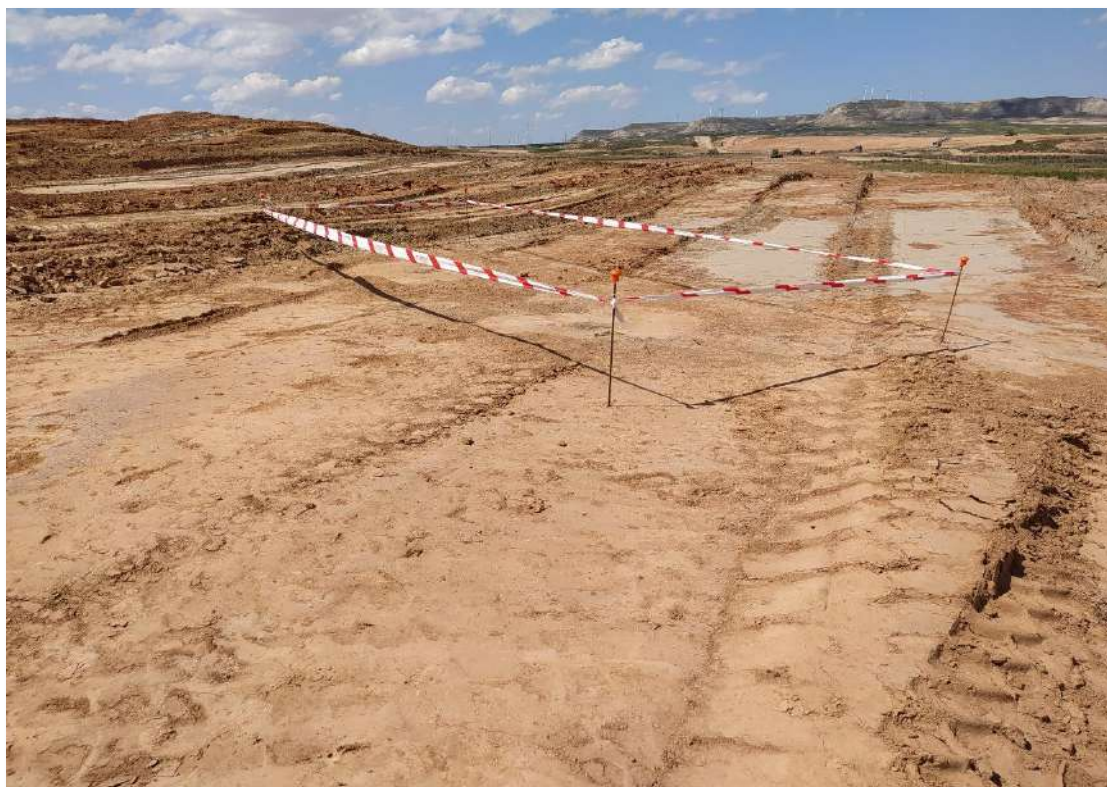
Foto1. Balizado de los elementos hallados durante las labores de control y seguimiento de los movimientos de tierra en zona 9 de PSFV Pitarco A oeste
