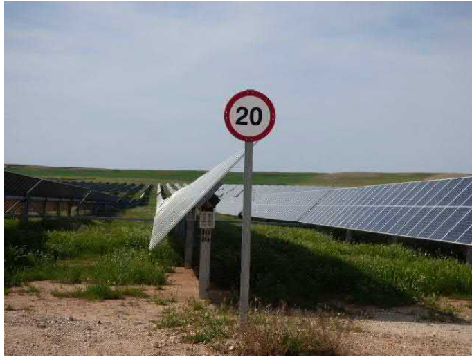
Imagen 13: Señal de límite de velocidad situada en el interior de los viales internos del parque fotovoltaico.
