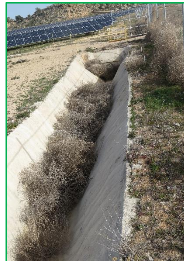
Figura 12. Cuneta cimentada con restos de capitanas
