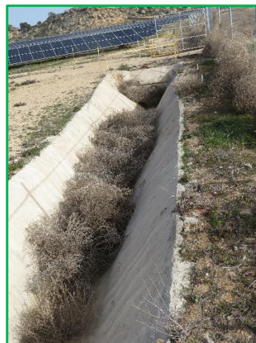
Figura 10. Cuneta cimentada con restos de capitanas
