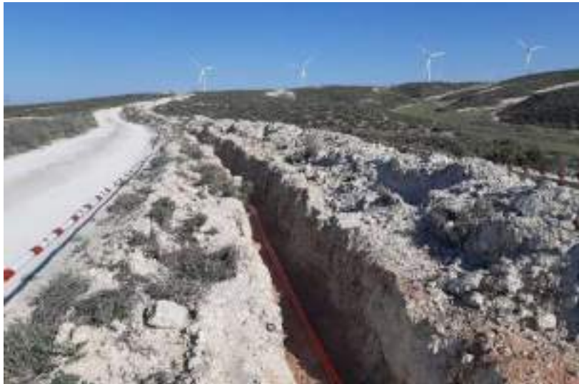
Tramo de zanja paralelo a camino, con los cables tendidos y pendiente de ser tapada y restaurada.
