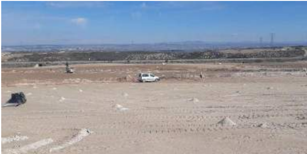
Perforaciones para el hincado de los soportes de los paneles en la parcela sur.
