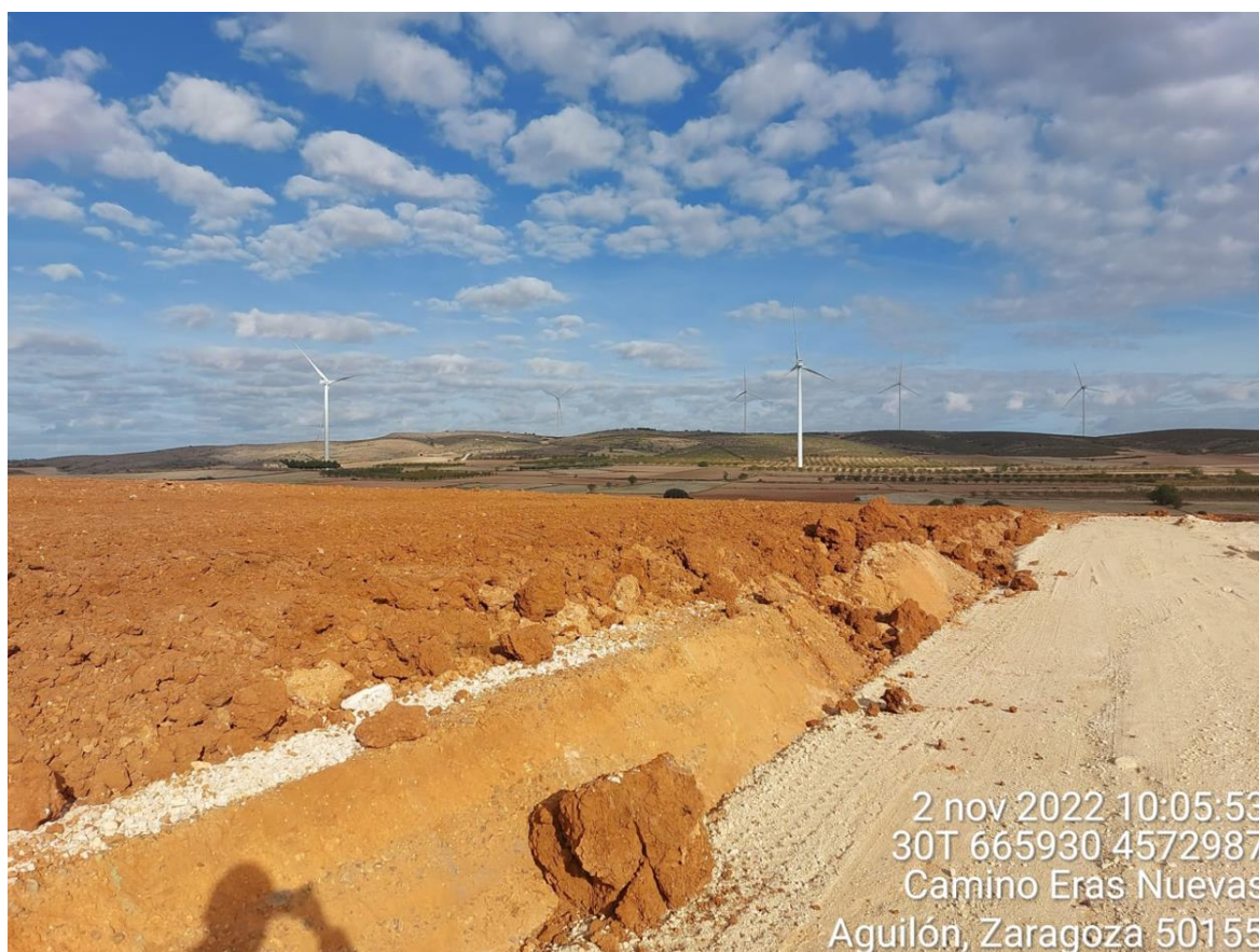
Imagen 1. Posición SBI-08 restaurada. Se debe actuar sobre los bolos de tierra de gran volumen originados durante los trabajos de restauración y que llegan hasta el vial de acceso al aerogenerador.
