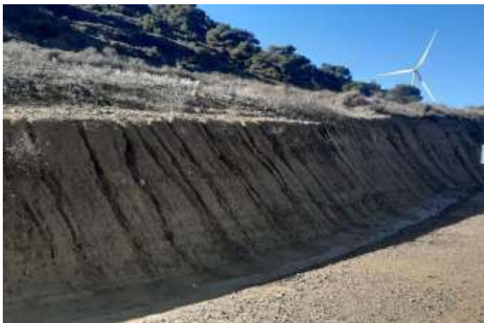
Fig. 5 Erosión hídrica en materiales margosos del talud de desmonte de plataforma del aero ML5.05. Fuente: Elaboración propia
