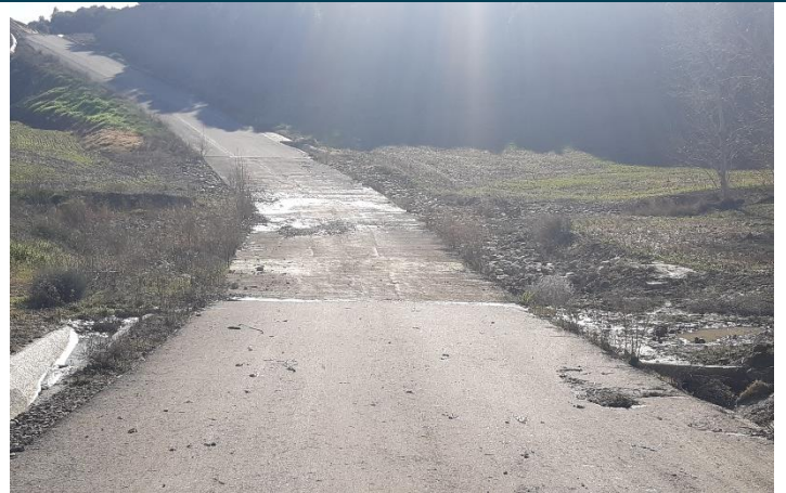
Fig. 2 Encharcamiento en vado en vial de acceso al aéro ML5.08. Fuente: Elaboración propia
