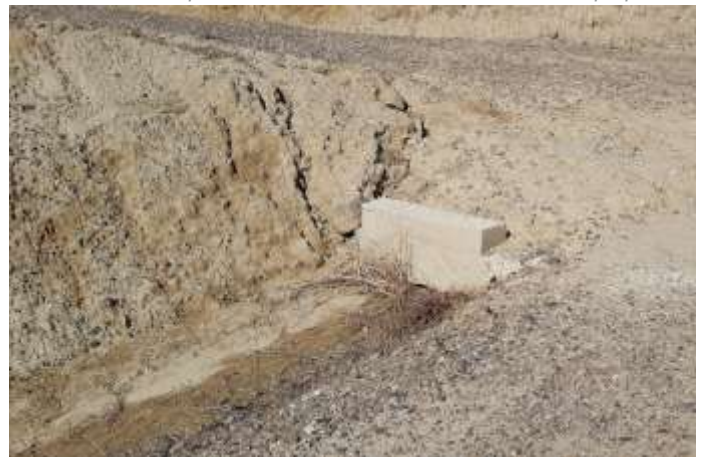
Fig. 4 Erosión hídrica en materiales margosos del talud de desmonte del vial de acceso al aero ML5.09. Fuente: Elaboración propia
