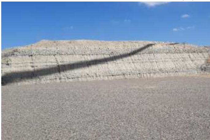
Fig. 3 Erosión hídrica en materiales margo-calizos del talud de desmonte de plataforma del aero ML5.04. Fuente: Elaboración propia
