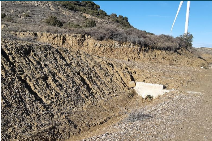
Fig. 1 Tubo de drenaje semitaponado con sedimentos en vial de acceso al aéro ML5.09. Fuente: Elaboración propia
