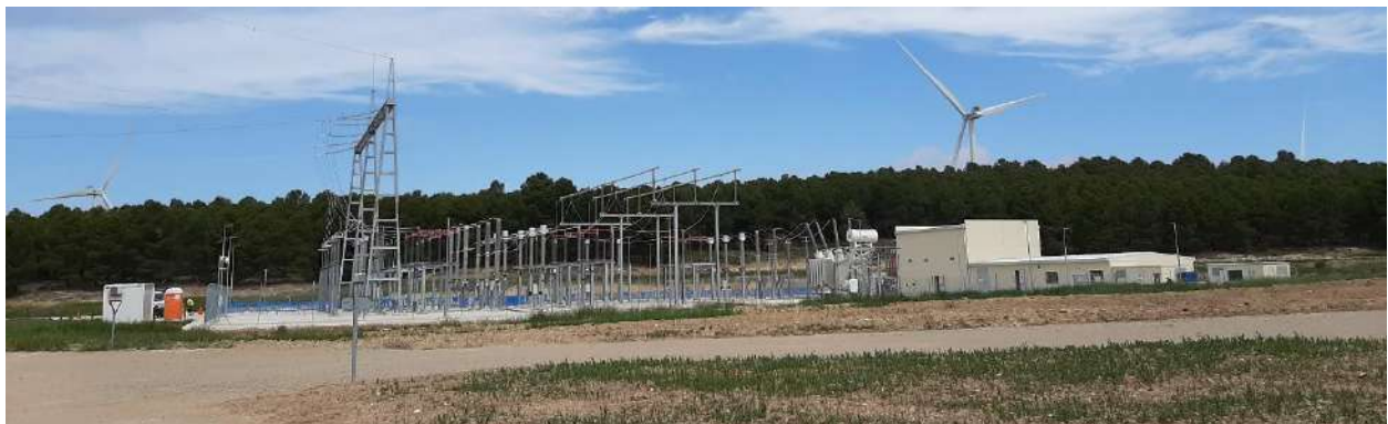
Figura 1: Vistas de la subestación Cañaseca.
