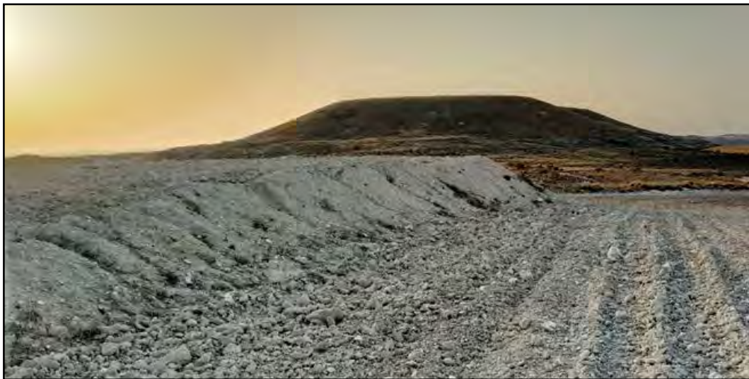
Fotografía 1. Pequeños regueros en el talud del aerogenerador HE01.
