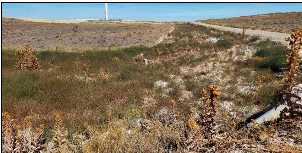
Fotografía 13. Zanja de media tensión provista de vegetación.
