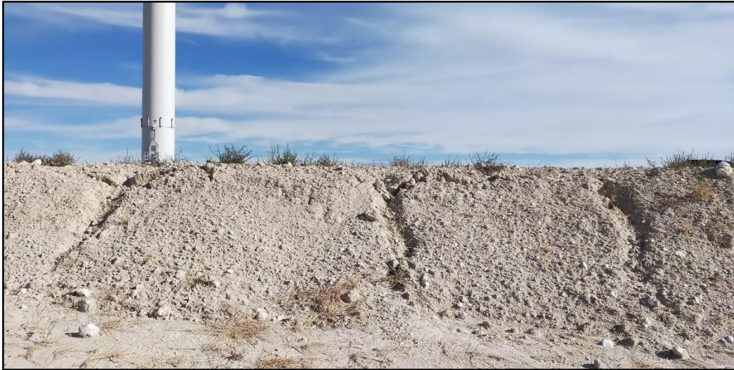
Fotografía 3. Pequeñas cárcavas en el talud del aerogenerador HE-01.
