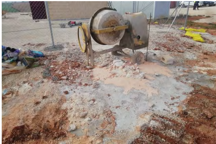
Foto 1 Residuos de hormigón.
