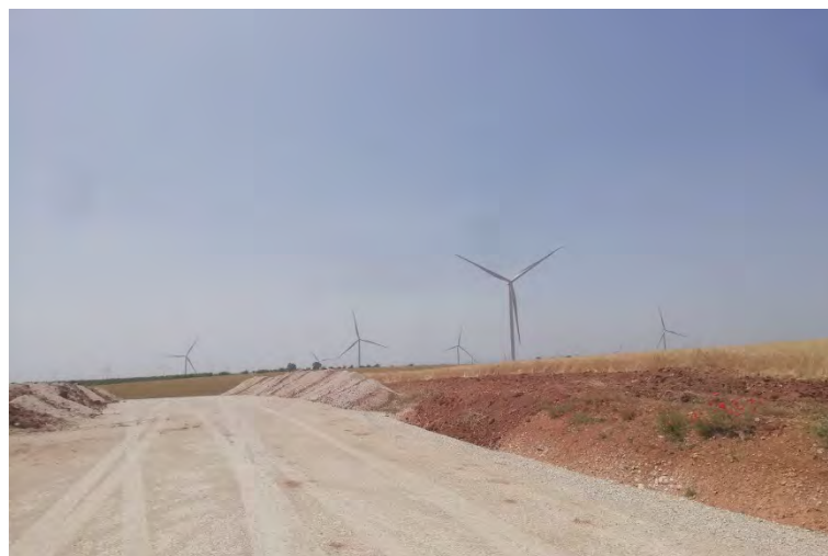
Foto 2 red de drenaje atravesando el vial.
