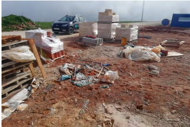
Foto 3 Residuos de hormigón y plásticos.
