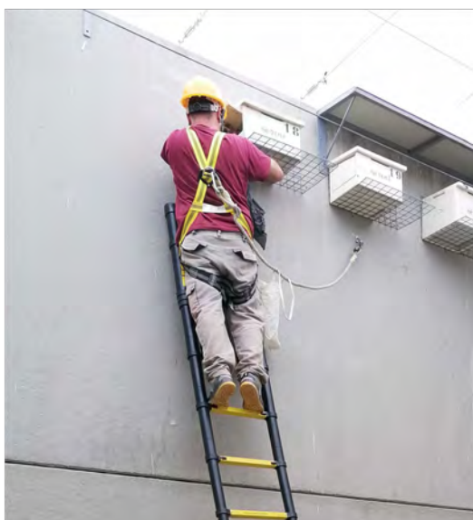
Foto 7 – Revisión, limpieza y cierre de nidos, por un técnico de DEMA. Fuente: DEMA.
