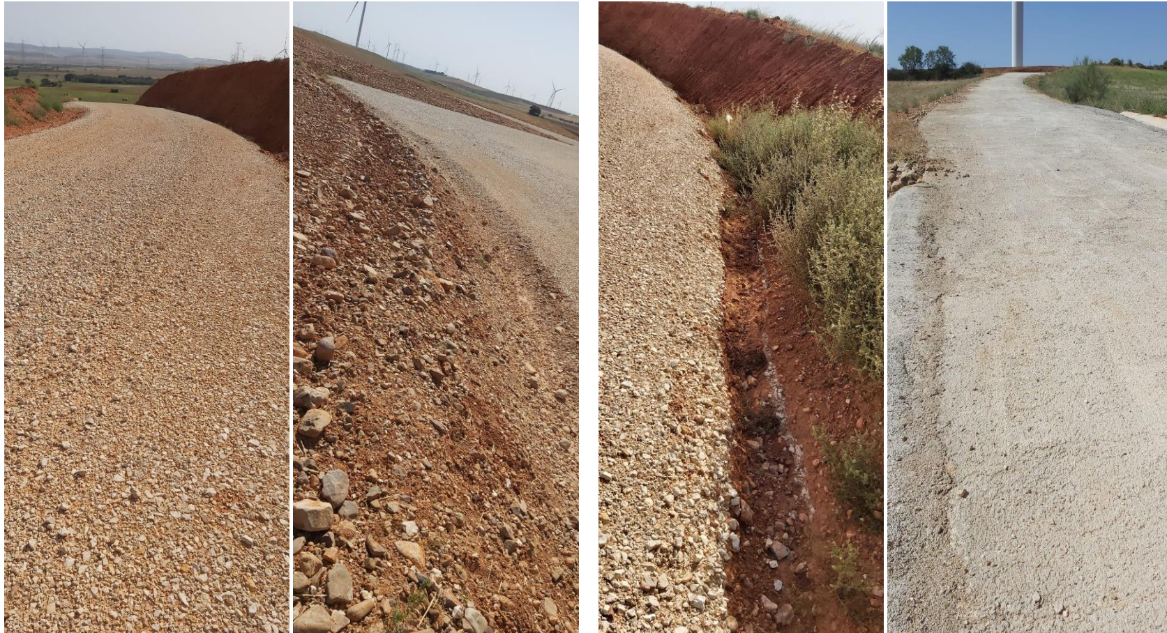
Fotografías 5 a 8: Estado de las redes de drenaje y viales.
