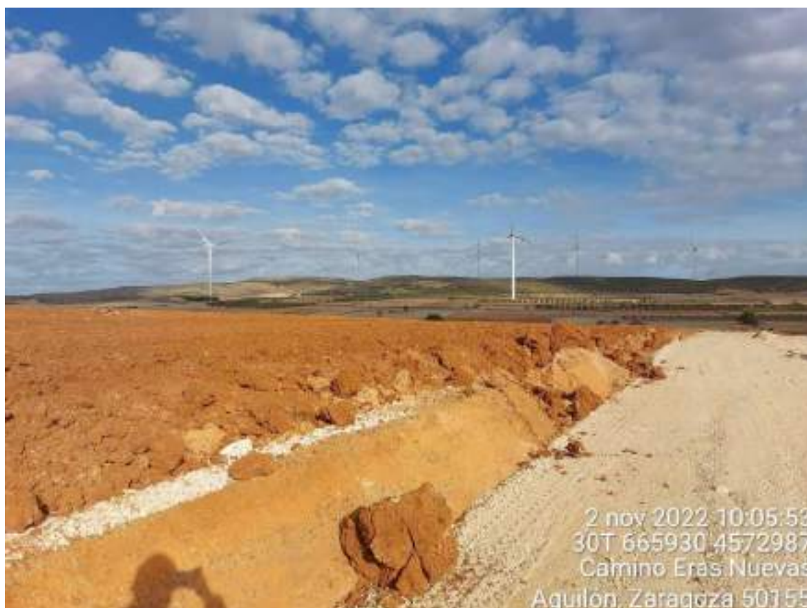
Imagen 1. Posición SBI-08 restaurada. Se debe actuar sobre los bolos de tierra de gran volumen originados durante los trabajos de restauración y que llegan hasta el vial de acceso al aerogenerador.
