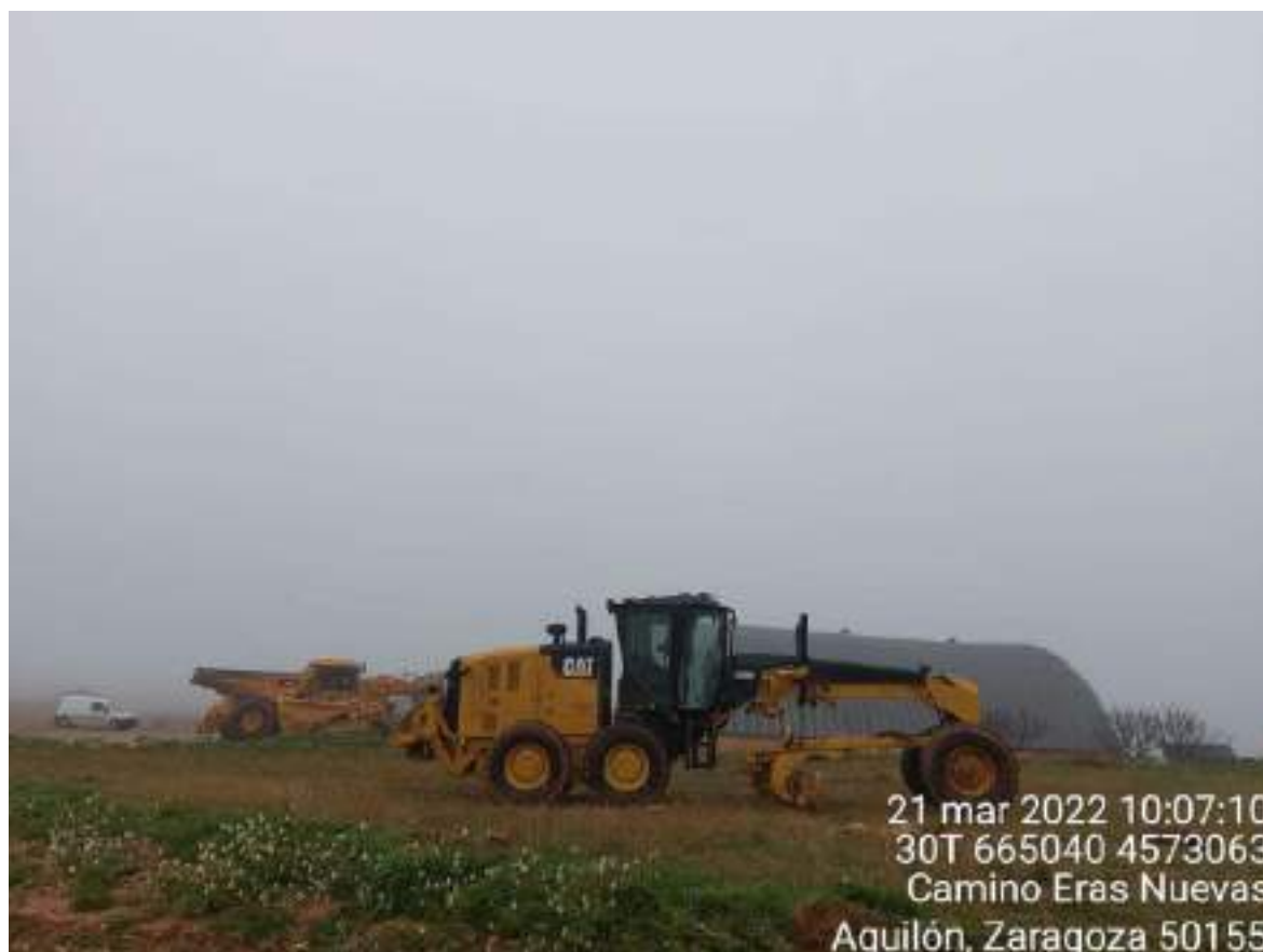
Imagen 3. Maquinaria parada debido al mal estado de los viales por la lluvia.
