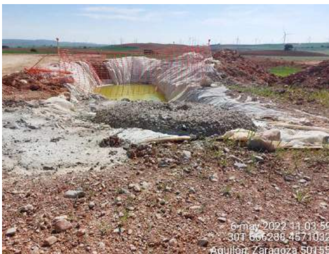
Ilustración 1. No conformidad grave. Pozo de lavado utilizado sin impermeabilizar el suelo.
