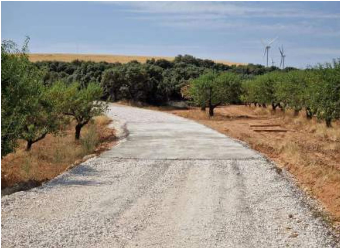
Imagen 2. Badén entre SB2-05 y SB2-06.
