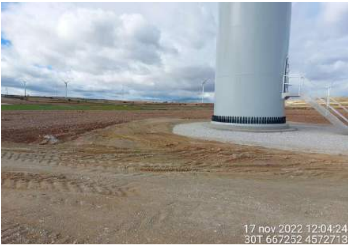
Imagen 3. Plataforma SBI-9 como ejemplo de que falta nivelar y eliminar las roderas existentes en la mayoría de las posiciones.
