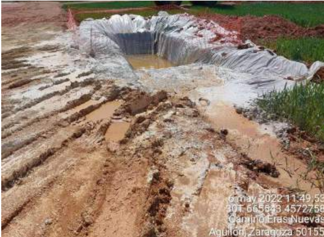
Ilustración 2. Pozo de lavado de SBI-7. Se consigue impermeabilizar el suelo del pozo, pero se contamina el suelo de la zona inmediata al pozo así como del cultivo. Se debe corregir y evitar situaciones así.
