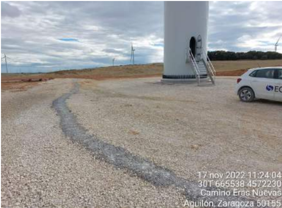
Imagen 2. Residuo de hormigón en SBII-6 que continúa por el vial de bajada.
