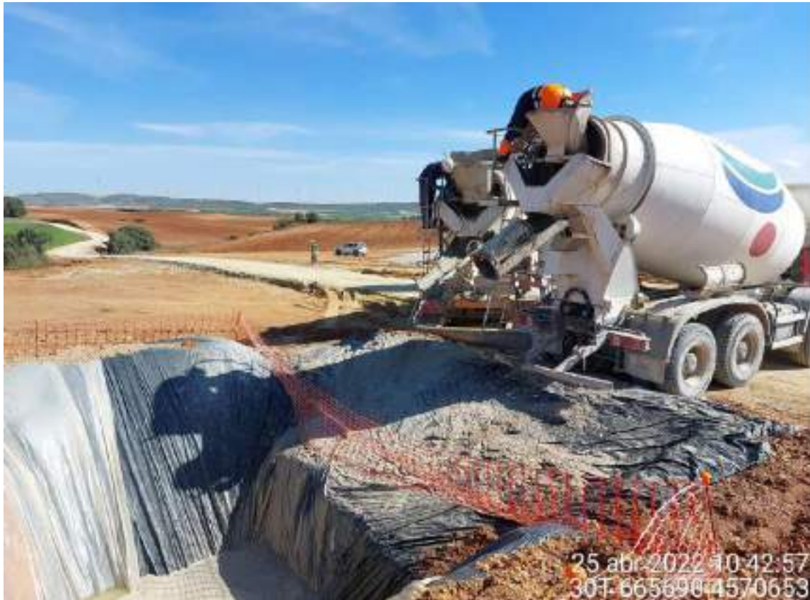
Imagen 2. Lavado de cubas de hormigón en el pozo de lavado en SBII-08.
