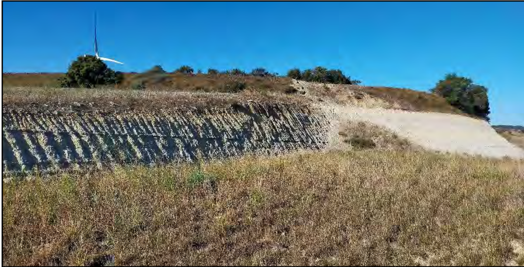
Fotografía 3. Herbáceas bajo el desmonte realizado en la turbina LP03 (02/08/2023)
