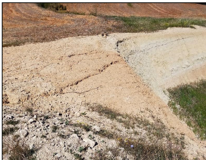
Fotografía 6. Pequeño reguero en la parte superior del desmonte en la turbina LP-10.
