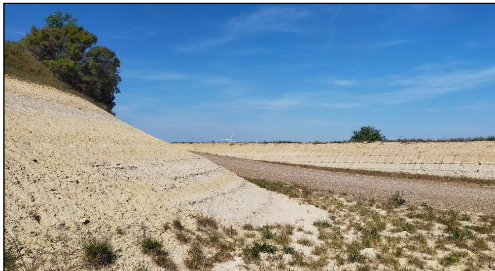
Fotografía 4. Desmonte desprovisto de vegetación en la turbina LP03
