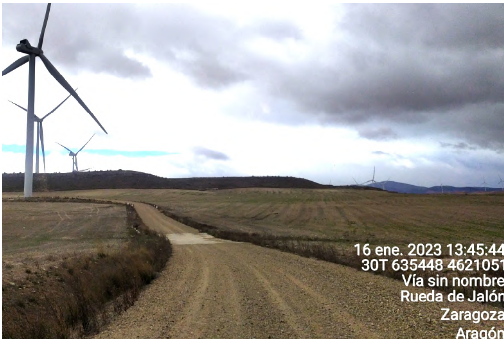
Figura 35: Fotografía de vial de acceso hacia ELL4 con el badén inundable en correcto estado de conservación.
