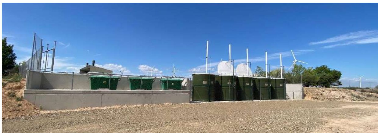
Nuevos contenedores para almacenamiento y autohidrólisis de cadáveres de porcino, ubicados en el núcleo ganadero.
